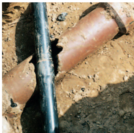
▲ Schäden an Abwasserkanälen sind relativ häufig. Dieser Abwasserkanal wurde zum Beispiel durch eine neue Leitung zerstört
